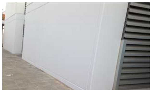
Pintura de l'Escola Enxaneta
